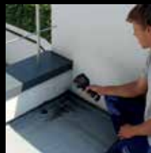
发现屋顶渗漏
