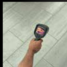
检查地板采暖，发现裂缝
