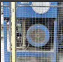
检查电力发动机的运转状态
